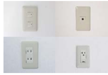
▲スイッチ、弱電配線、コンセント
